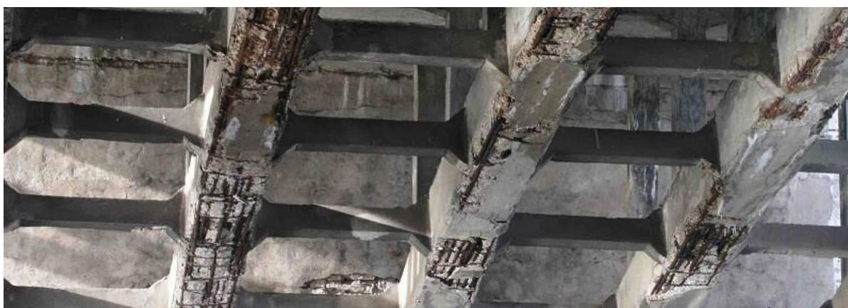
Рисунок 2. Локальные повреждения железобетонных конструкций
